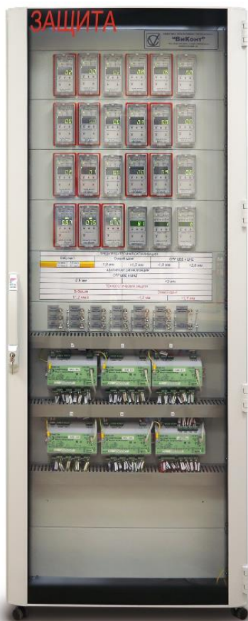
Рисунок 1 – Общий вид стойки управления
