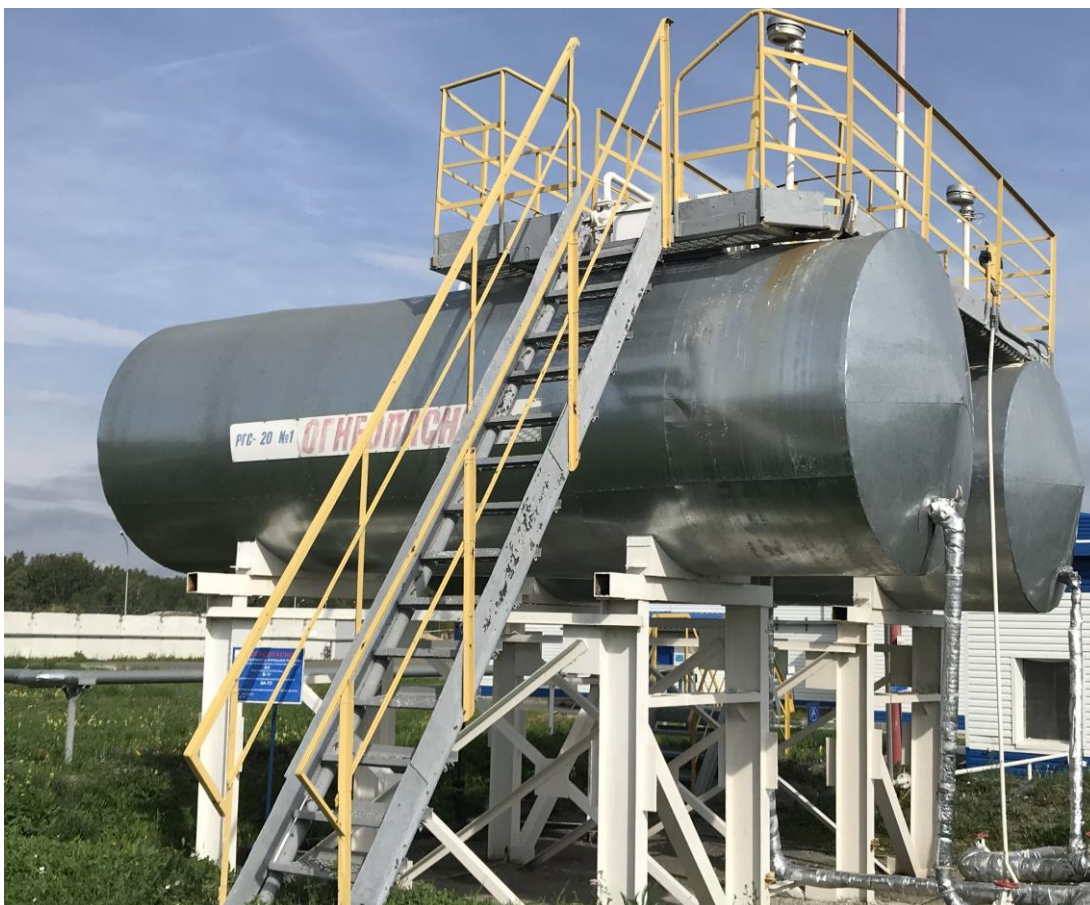
Рисунок 2 – Общий вид резервуаров РГС-20
