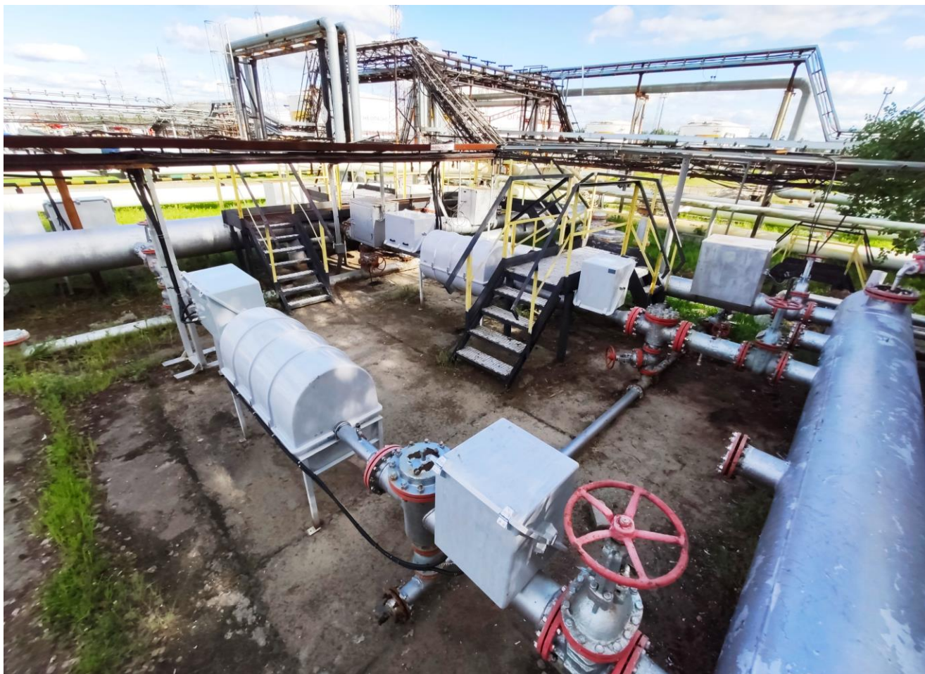
Рисунок 1 – Общий вид СИКН
