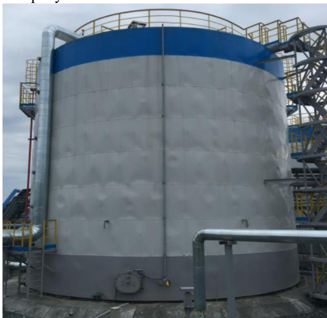
Рисунок 1 – Общий вид резервуаров стальных вертикальных цилиндрических теплоизолированных РВС-2000
