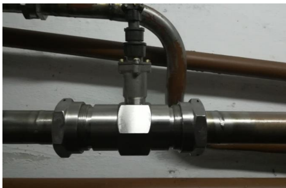
Рисунок 11 – Турбинный преобразователь расхода ТПР14-2-1. Монтаж по месту
