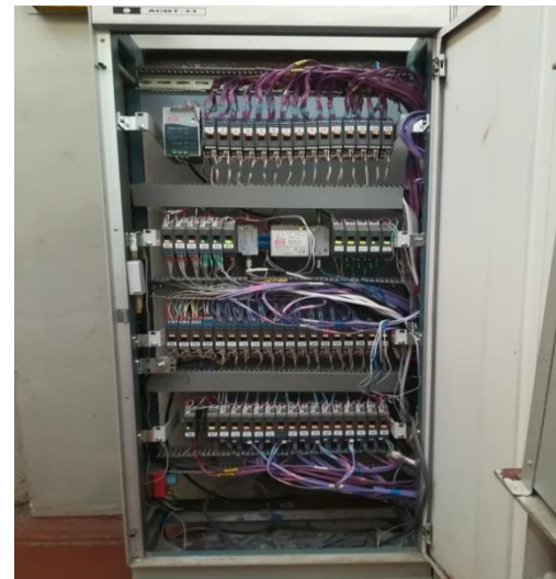
Рисунок 4 – ШкТП, вид с лицевой стороны
