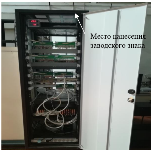
Рисунок 3 – Стойка ИВК (без двери), вид с лицевой стороны
