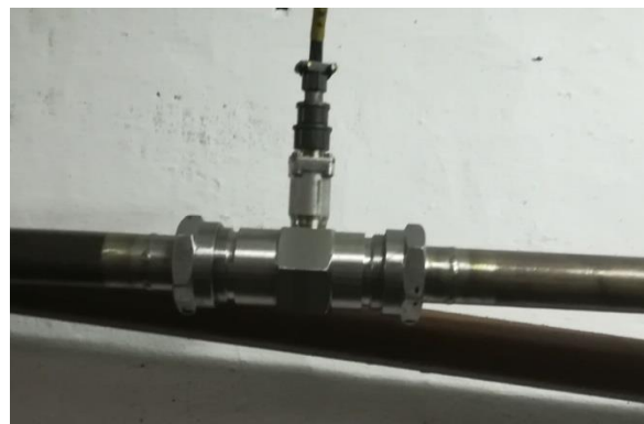
Рисунок 12 – Турбинный преобразователь расхода ТПР11-1-1. Монтаж по месту
