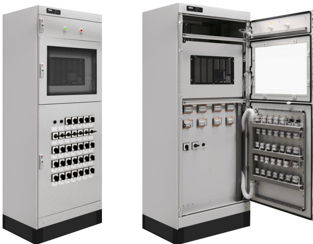
Рисунок 1 – Общий вид комплексов противоаварийной автоматики и релейной защиты МКПА-РЗ
