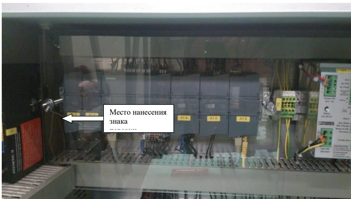
Рисунок 3 – Место нанесения знака поверки в шкафу управления
