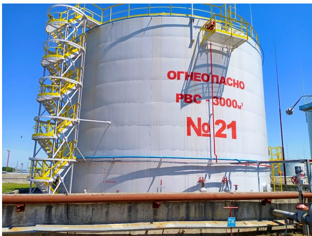
Рисунок 2 – Фотография общего вида резервуара вертикального стального цилиндрического RBC-3000 заводской номер 21
