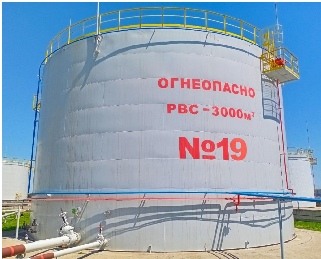
Рисунок 1 – Фотография общего вида резервуара вертикального стального цилиндрического RBC-3000 заводской номер 19
