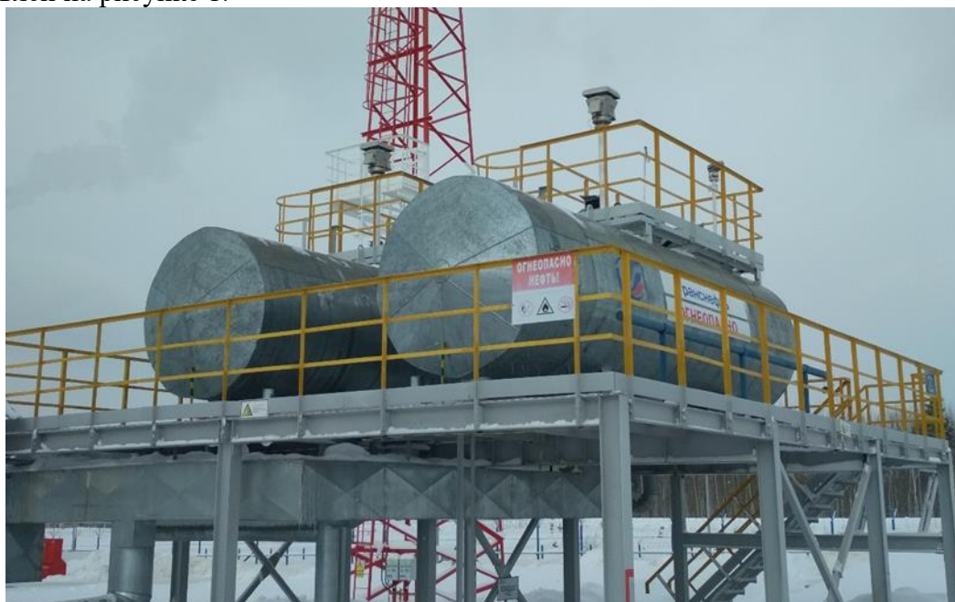
Рисунок 1 – Общий вид резервуаров РГС-20
