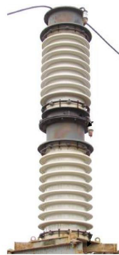
Рисунок 2 – Общий вид трансформаторов напряжения НКФ-220-58 У1
