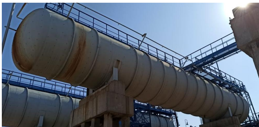
Рисунок 1 – Общий вид резервуаров РГС-200
