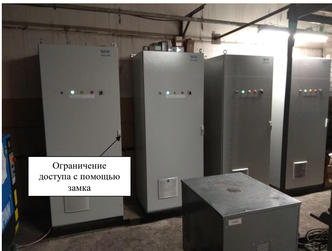
Рисунок 7 – Общий вид газоаналитического оборудования
