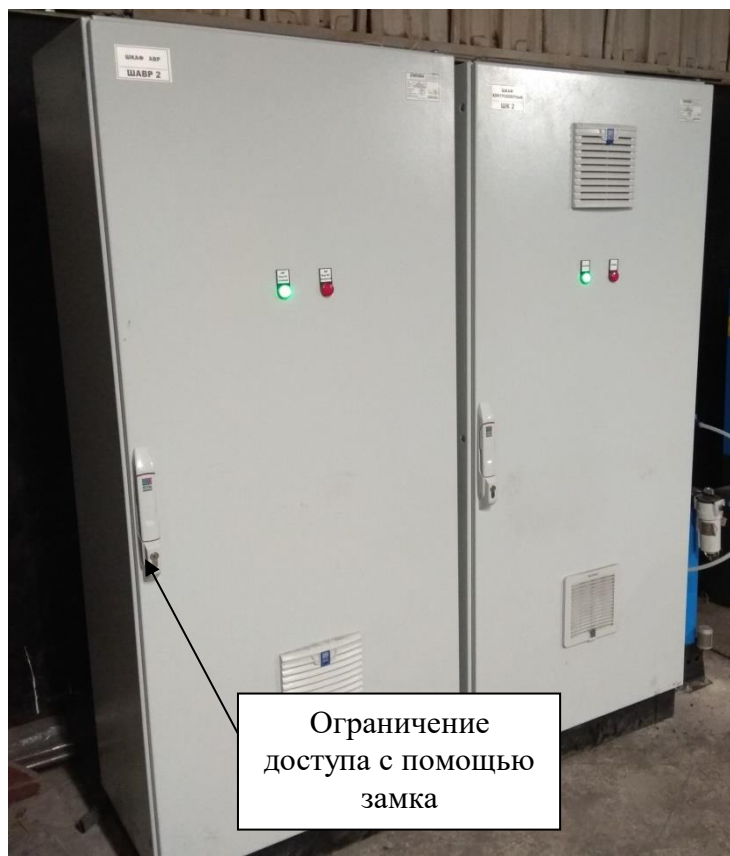
Рисунок 6 – Общий вид контроллерного шкафа
