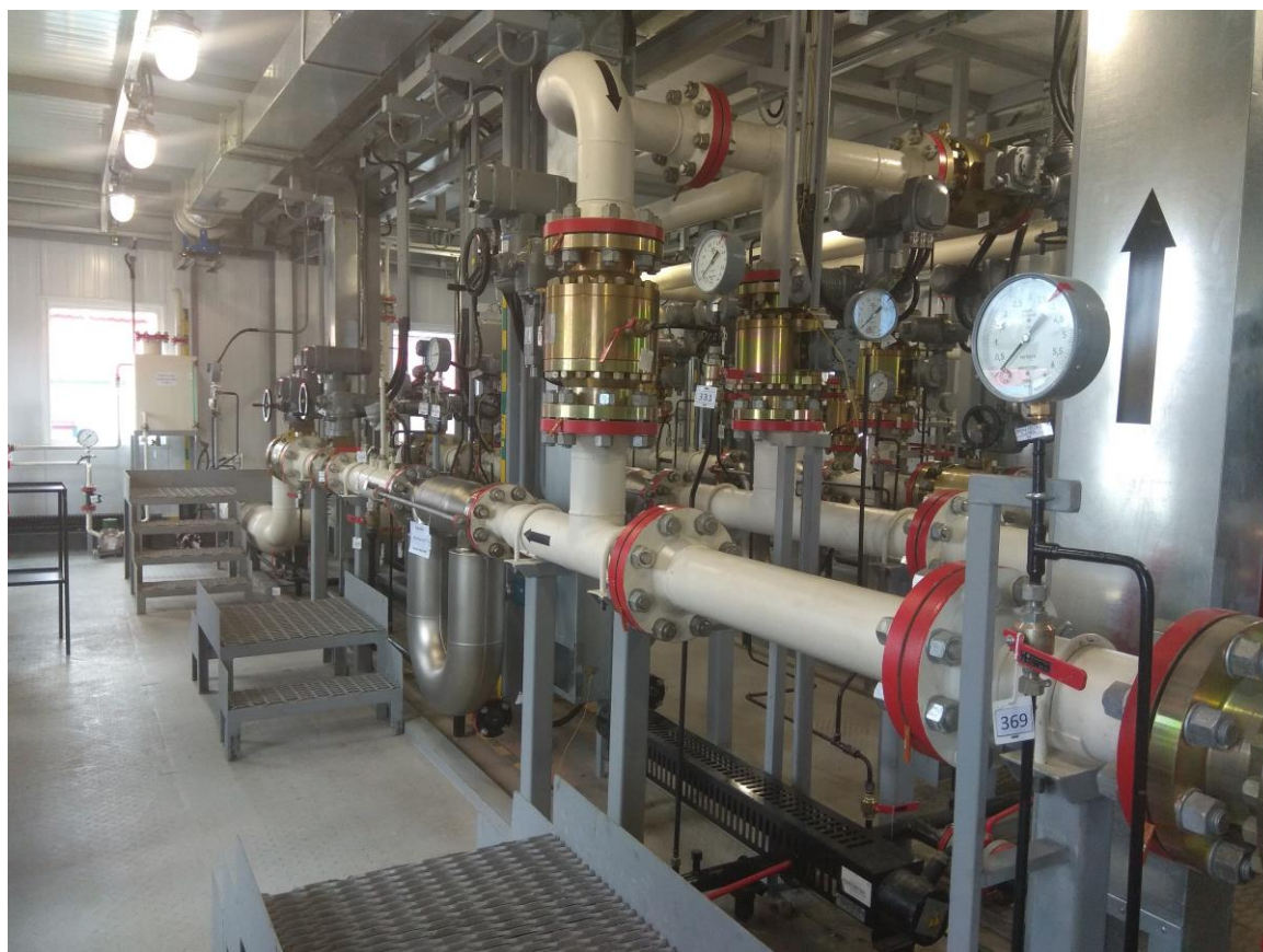
Рисунок 1 – Общий вид СИКН
