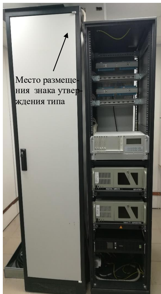
Рисунок 2 – Стойка ИВК (слева) и стойка АСУТП (справа без двери). Внешний вид
