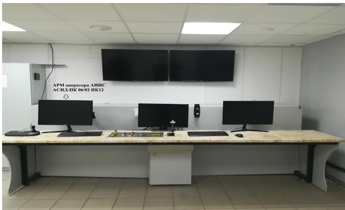
Рисунок 1 – Пульта управления с АРМ-ами АИИС (слева), управления изделием (по центру) и АСУТП (справа)
