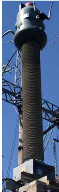
Рисунок 1 - Общий вид трансформаторов
