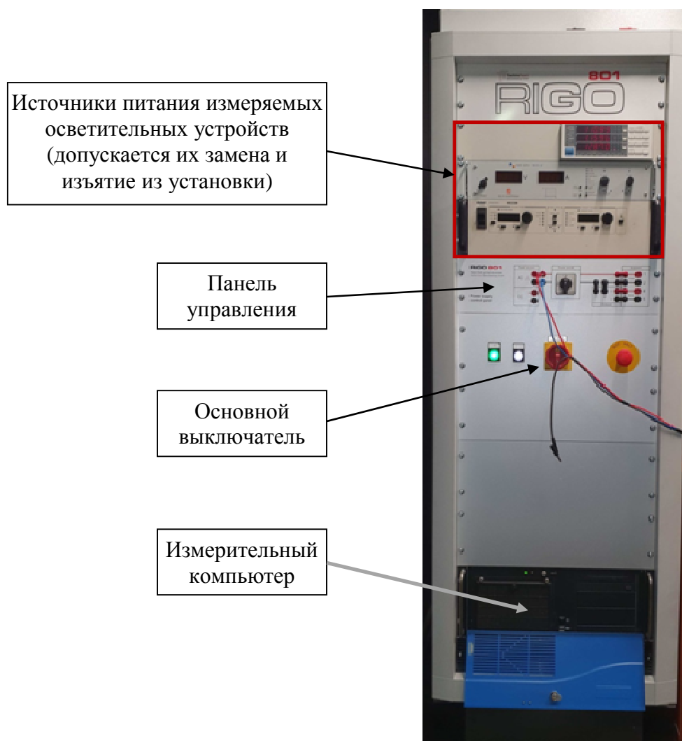
Рисунок 2 – Общий вид электрического шкафа управления гониофотометром
