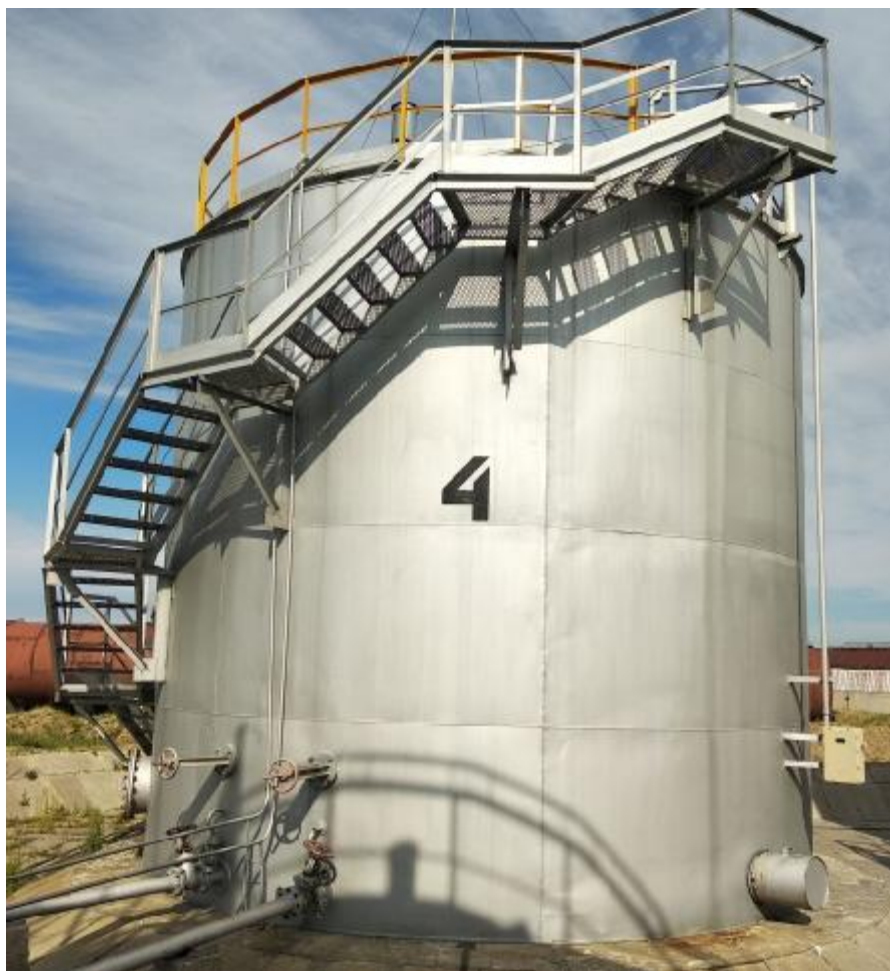
Рисунок 1 - Резервуар вертикальный стальной РВС-200
