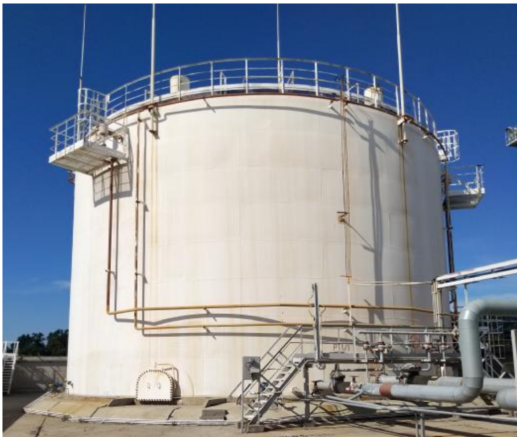
Рисунок 1 – Общий вид резервуаров стальных вертикальных цилиндрических РВСп-3000
