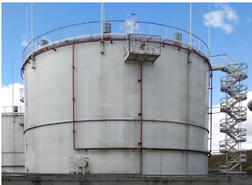
Рисунок 2 – Общий вид резервуаров стальных вертикальных цилиндрических РВСп-5000
