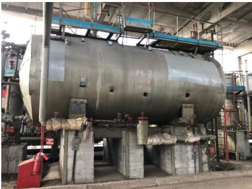
Рисунок 1 – Общий вид резервуара горизонтального стального цилиндрического РГС-50
