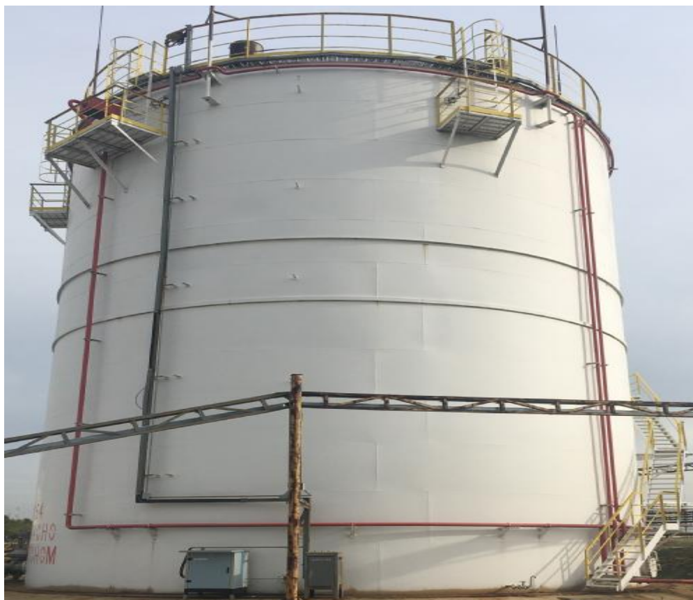
Рисунок 2 – Общий вид резервуара стального вертикального цилиндрического РВСП-3000
