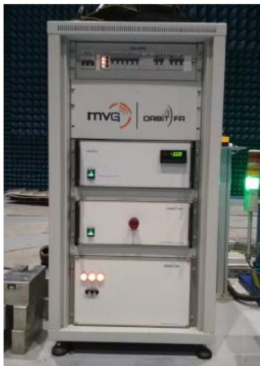
Рисунок 17 – Общий вид стойки контроллера опорно-поворотного устройства
