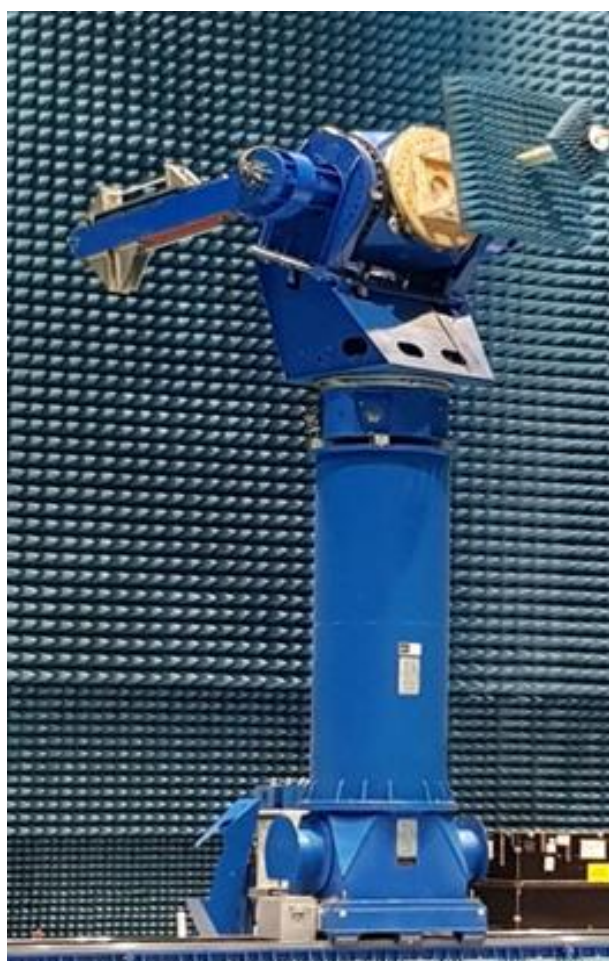
Рисунок 7 - Общий вид позиционера измеряемого объекта в коллиматорном режиме из состава ТМП 0515002 (опорно-поворотное устройство) в радиобезэховой экранированной камере ТМ ЭК 42.0x28.3x18.0
