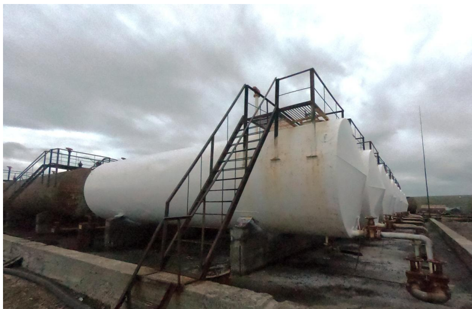
Рисунок 1 – Общий вид резервуаров РГС-60
