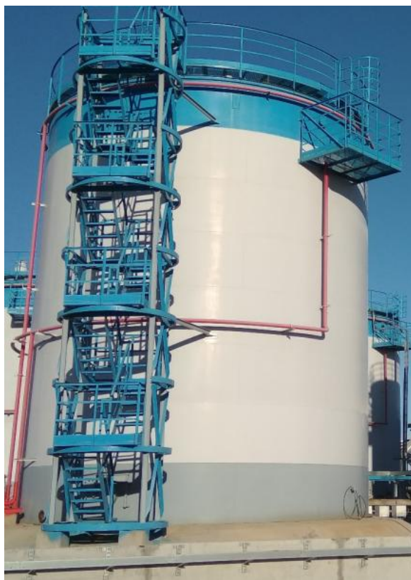
Рисунок 1 – Общий вид резервуаров стальных вертикальных цилиндрических РВСП-1000
