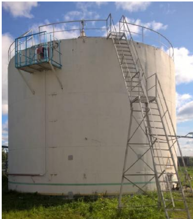
Рисунок 2 – Общий вид резервуара вертикального стального цилиндрического РВСП-1000
