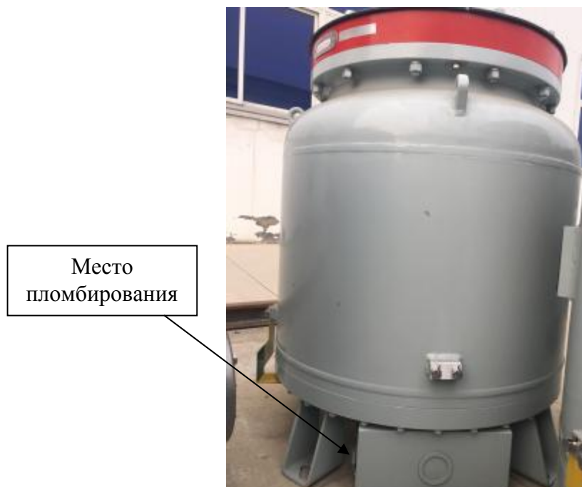
Рисунок 1 - Общий вид трансформаторов с указанием места пломбирования от несанкционированного доступа
