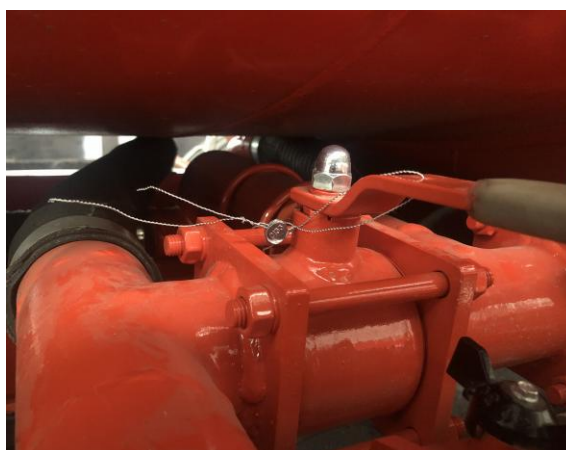
Рисунок 5 – Кран шаровый на трубопроводе
