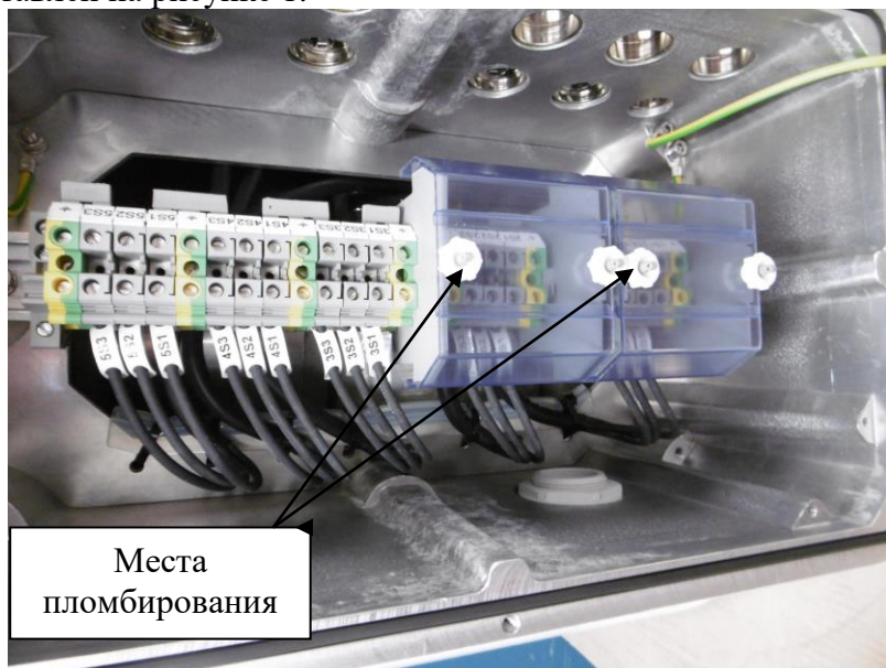
Трансформаторы с указанием мест пломбирования от несанкционированного доступа
