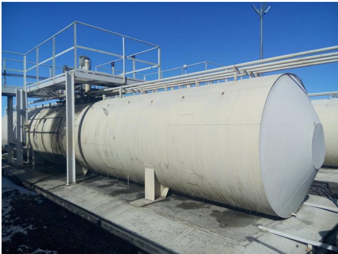
Рисунок 1 – Общий вид резервуаров РГСД-40
