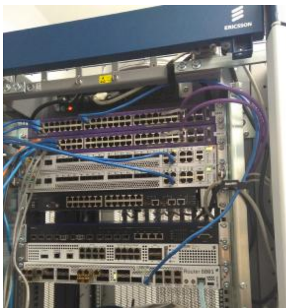
Рисунок 1 – Внешний вид оборудования в стойке
