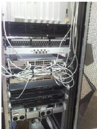
Рисунок 1 - Общий вид оборудования с открытой дверью
