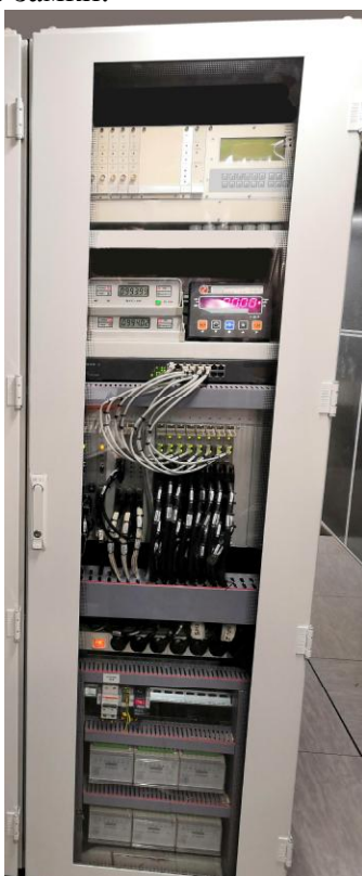
Рисунок 1 - Шкаф измерительного оборудования
