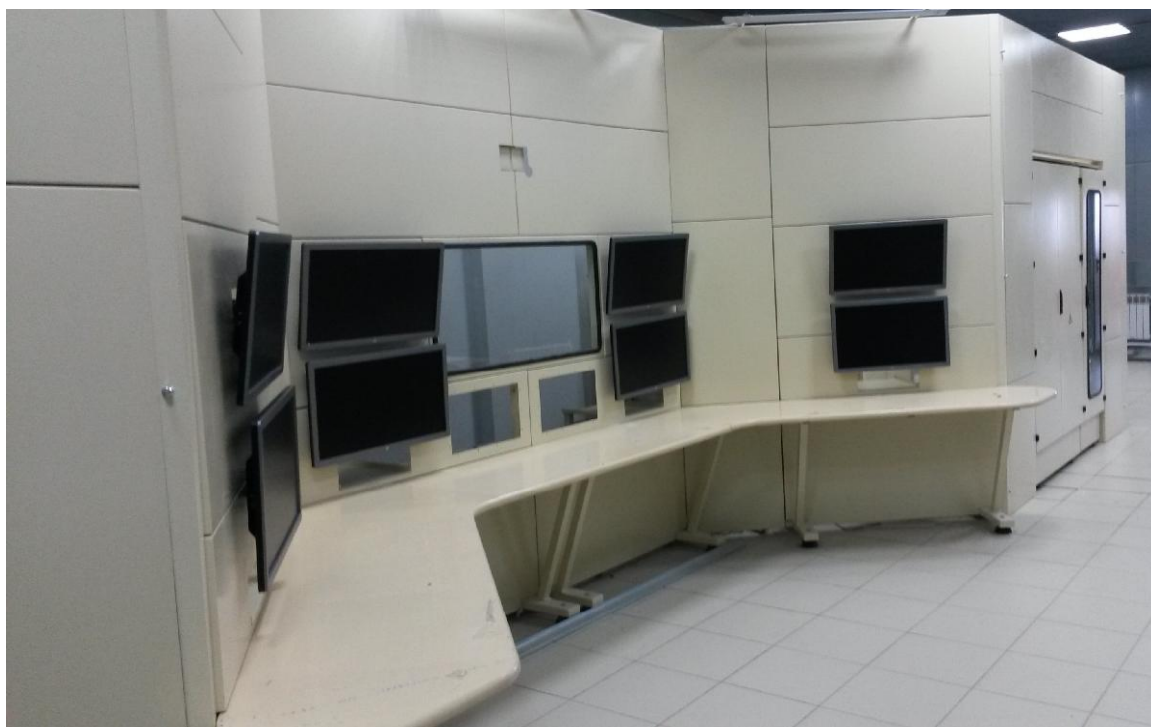
Рисунок 1 - Пульт управления испытаниями ГТД. Вид внешний
