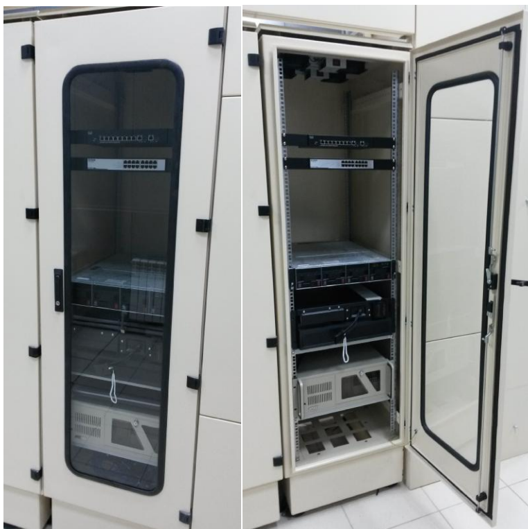
Рисунок 3 - Общий вид серверной стойки
