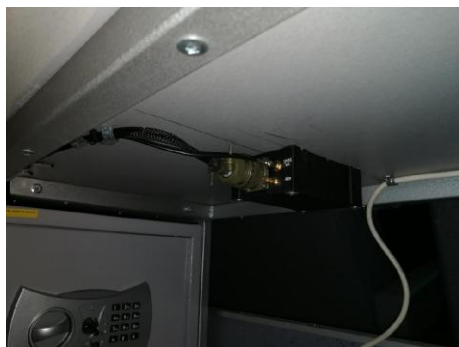
Рисунок 11 – Место установки инерциальной навигационной системы канала измерений геометрических параметров
