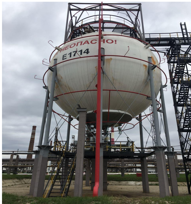
Рисунок 1 - Общий вид резервуаров шаровых стальных РШС-600
