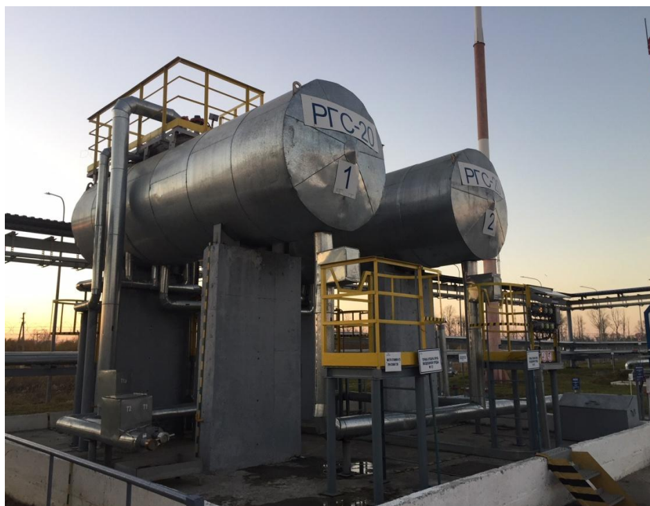
Рисунок 2 - Общий вид резервуаров PGC-20 № 0069-2012, № 0070-2012
