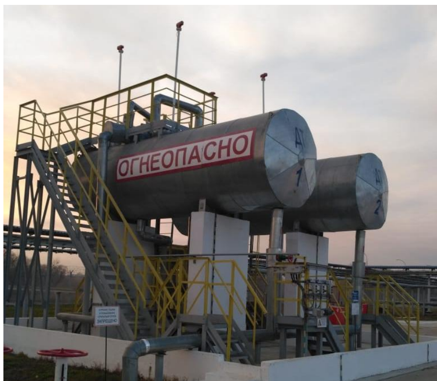
Рисунок 1 - Общий вид резервуаров РГС-20 № 0067-2012, № 0068-2012
