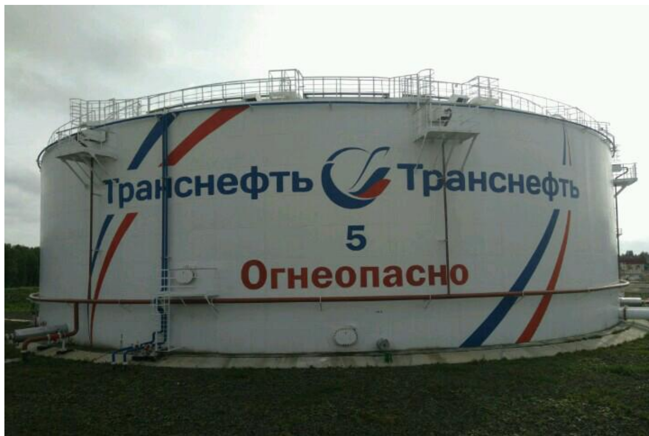
Рисунок 4 - Общий вид резервуара вертикального стального цилиндрического РВСП-20000
