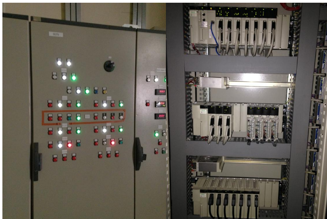
Рисунок 1 – Общий вид шкафов КИ АСДКУ ККВ РСВ
