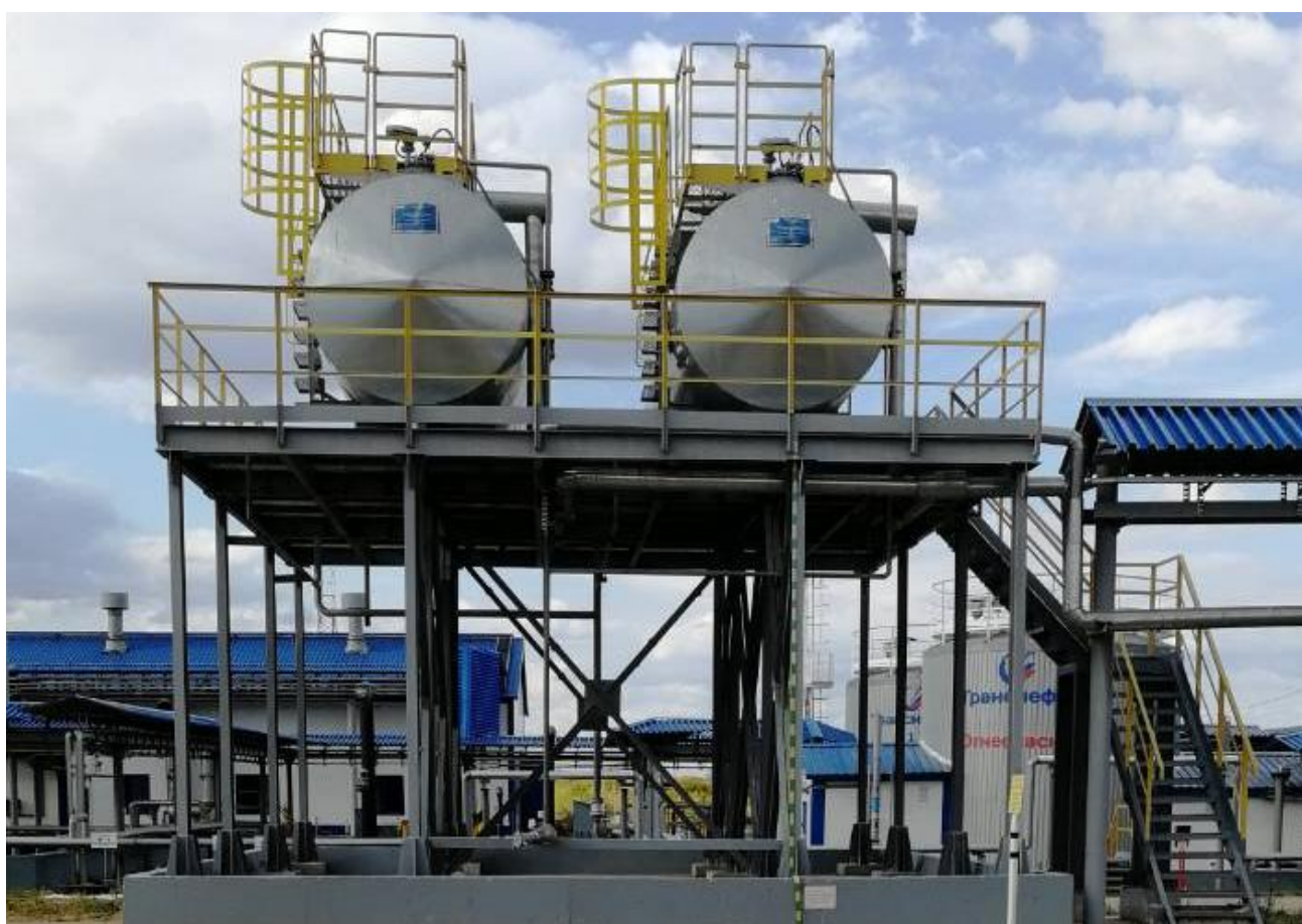
Рисунок 2 - Общий вид резервуаров РГС-20 №№ 275, 276
