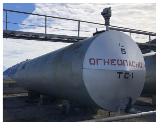
Рисунок 6 - Общий вид резервуаров стальных горизонтальных цилиндрических РГС-75
