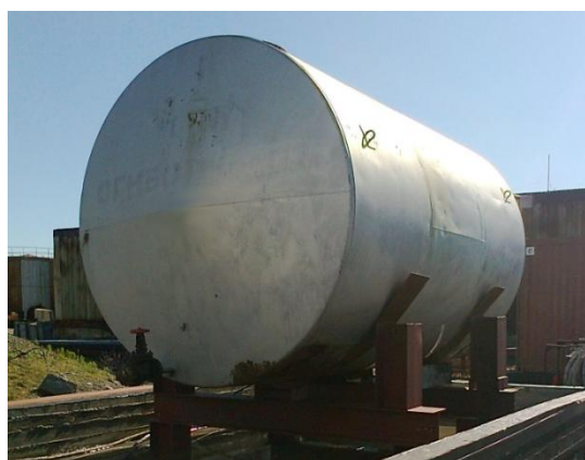
Рисунок 1 - Общий вид резервуаров стальных горизонтальных цилиндрических РГС-4
