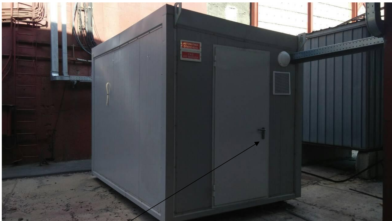
Для защиты от несанкционированного доступа контейнер АСИВ закрывается на замок Рисунок 1 – Общий вид контейнера
