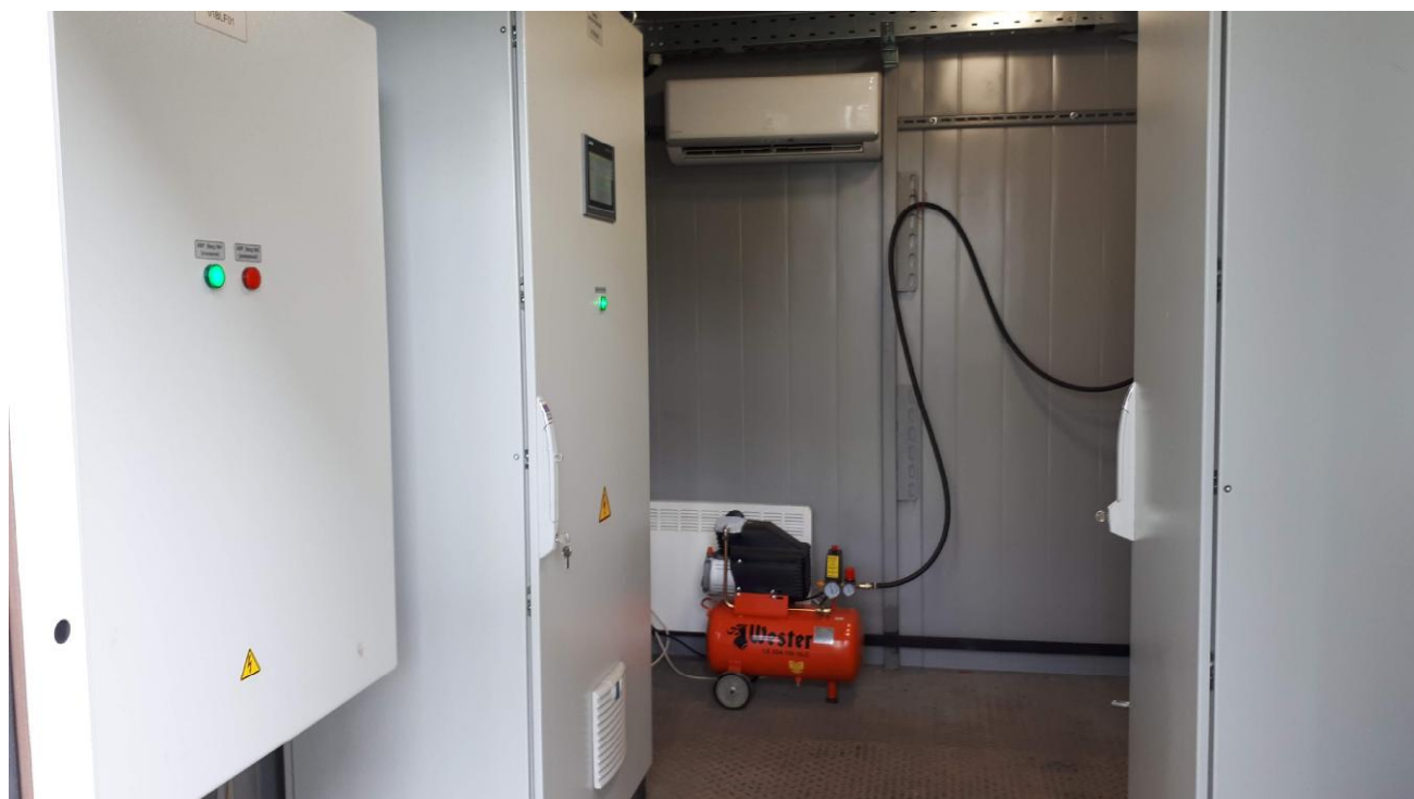
Рисунок 2 – Вид внутри контейнера
