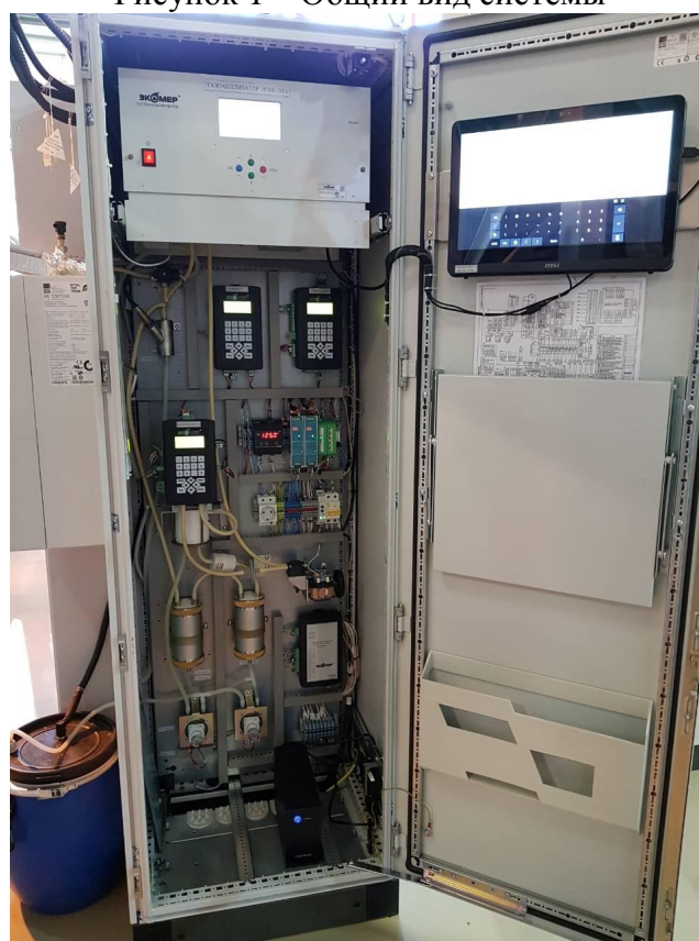
Рисунок 2 – Вид внутри шкафа газоаналитической части системы
