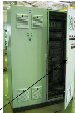
Общий вид шкафа ШУСР
