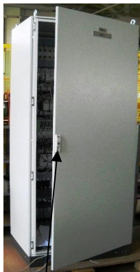
Общий вид шкафа ШУС
