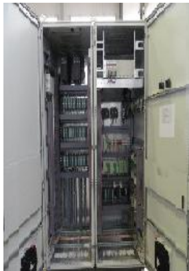
Общий вид шкафа МСКУ
