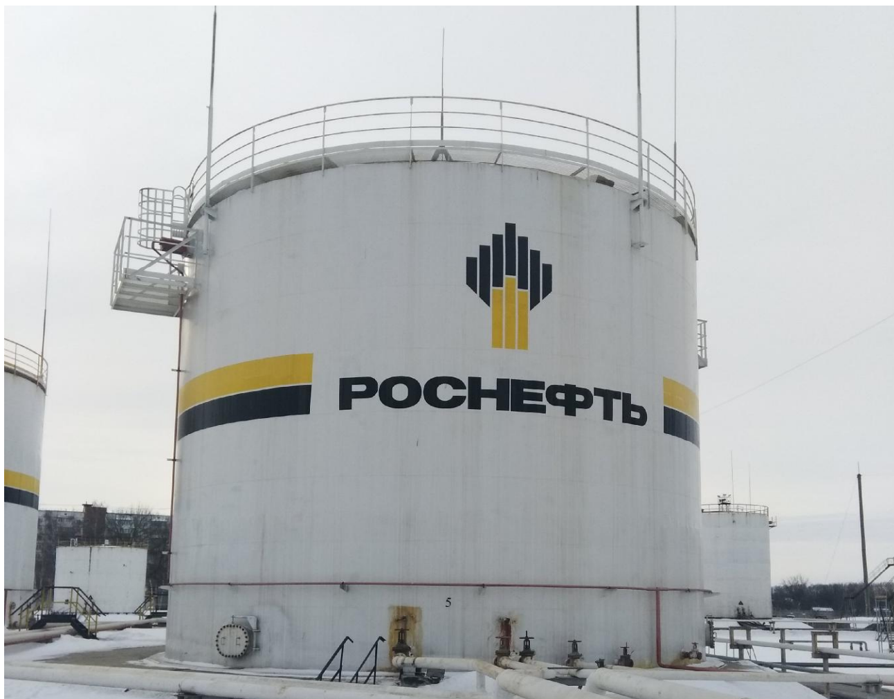
Рисунок 1 – Общий вид резервуара стального вертикального цилиндрического РВСП-2000
