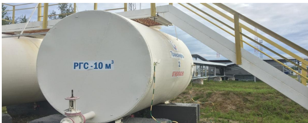
Рисунок 1 - Общий вид резервуаров стальных горизонтальных цилиндрических РГС-10
