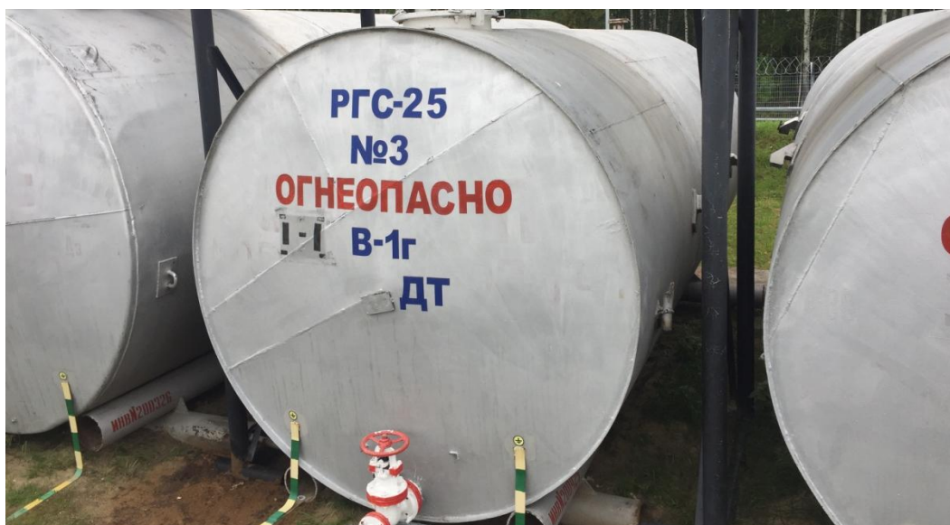
Рисунок 2 - Общий вид резервуаров стальных горизонтальных цилиндрических РГС-25
