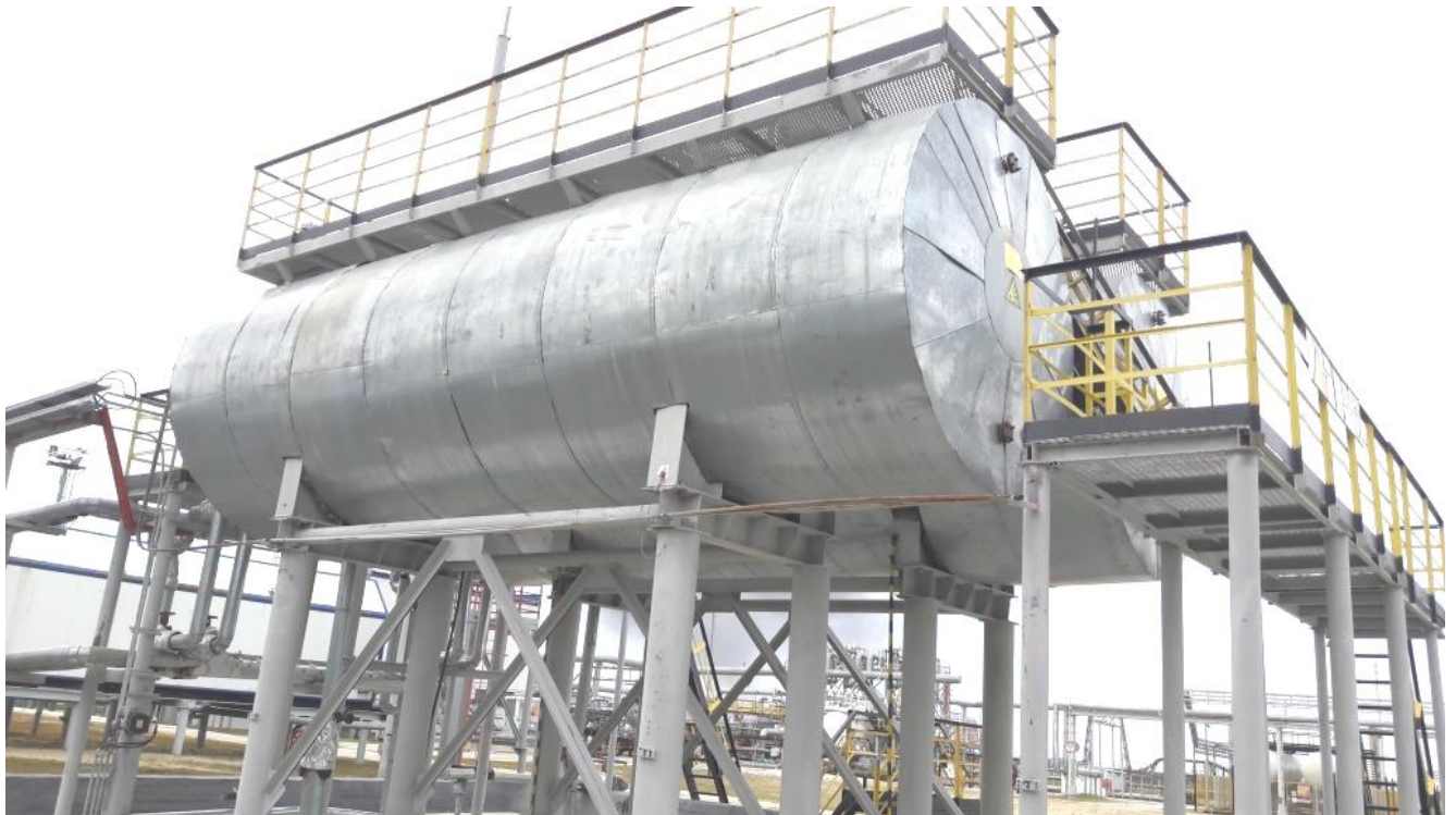
Рисунок 1 - Общий вид резервуаров стальных горизонтальных цилиндрических РГС-50
