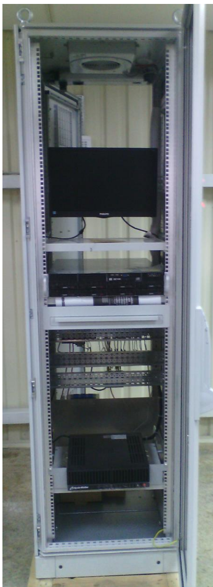
Рисунок 1 – Общий вид шкафа автоматизированного рабочего места
