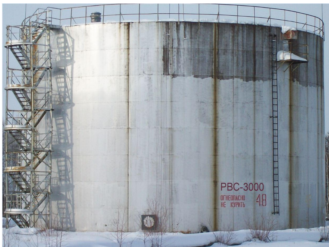
Рисунок 6 - Общий вид резервуара PVC-3000
