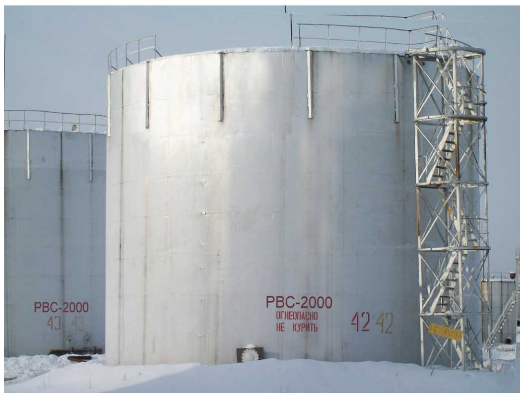
Рисунок 5 - Общий вид резервуара PVC-2000
