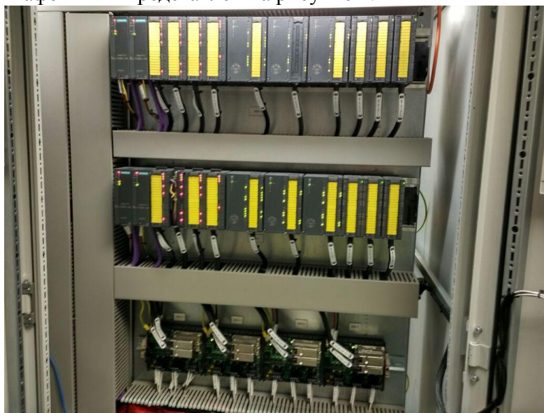
Рисунок 1 – Общий вид шкафов ПТК
