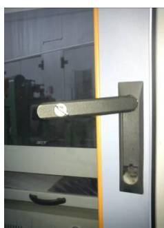
Рисунок 9 - Внешний вид замка на дверце стойки управления
